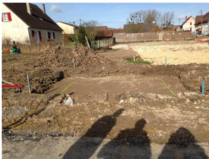
Plateforme du Poste de Transformation
